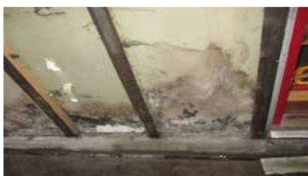
Skader på altanpladerne.
